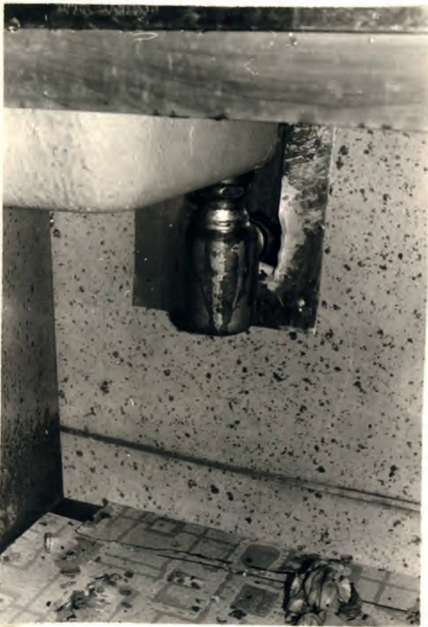
BRANDURSACHE: Lötarbeiten beim Siphon in der Küche.
