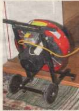
Starke Ventilatoren bliesen den letzten Rauch aus den Wohnungen.
