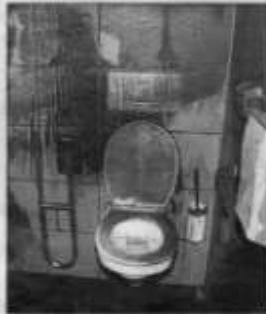
EIN BEHINDERTEN-WC total zerstört, die Fälle häufen sich. Foto: Hall AG
