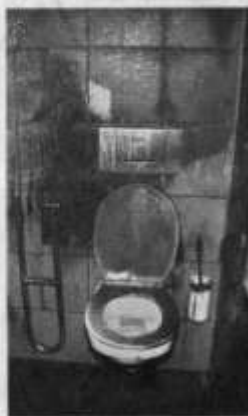
Die Behindertentoilette wurde an der Mitteldiensthaft gezeigert. Foto: Hall AG
