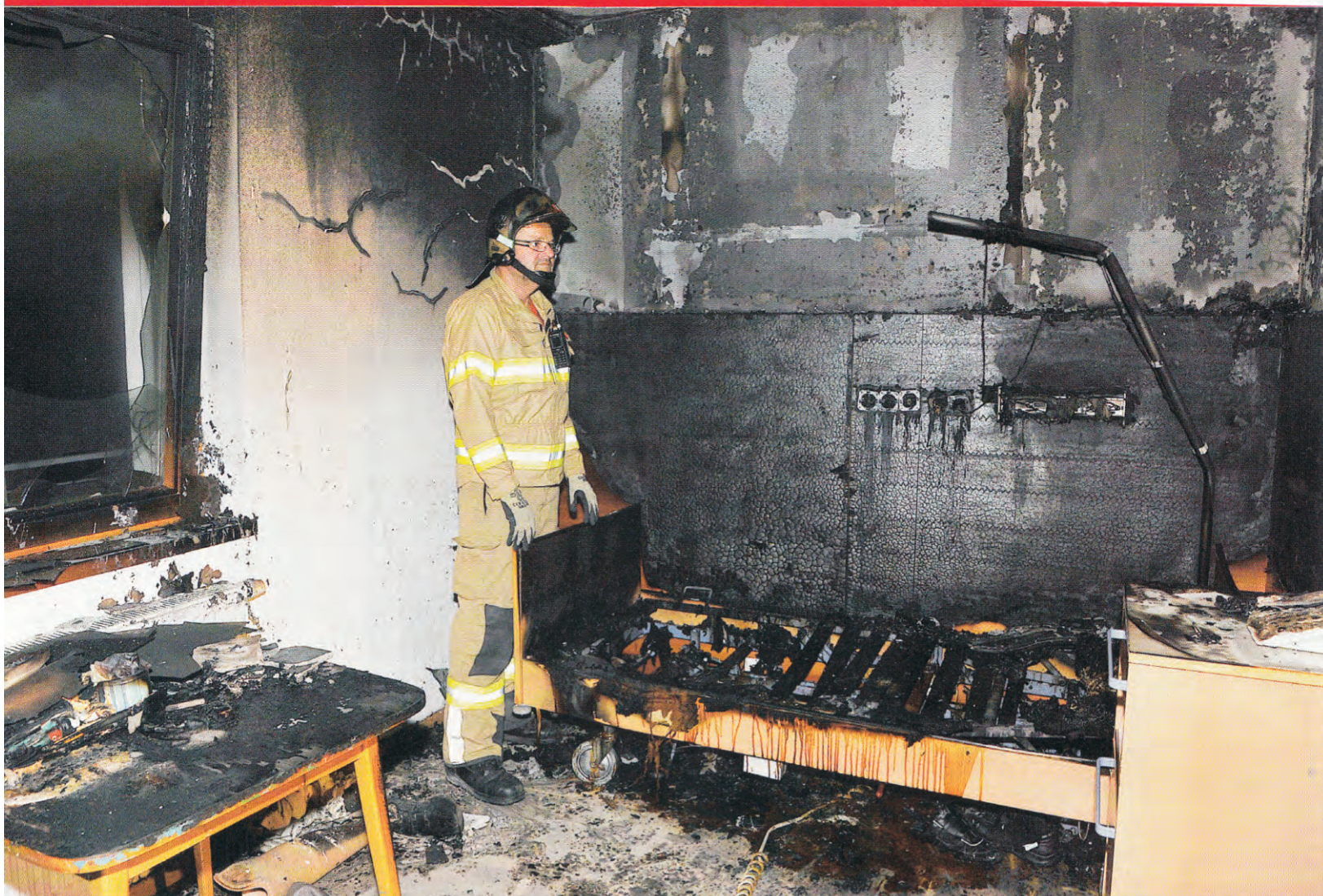
Das Zimmer wurde komplett verwüstet – größerer Schaden konnte durch das schnelle Eingreifen der Feuerwehr verhindert werden.
