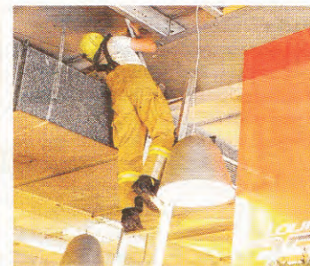
Die Feuerwehr prüfte den Zustand des Dachstuhls. Es wurde Instabilität vermutet.
