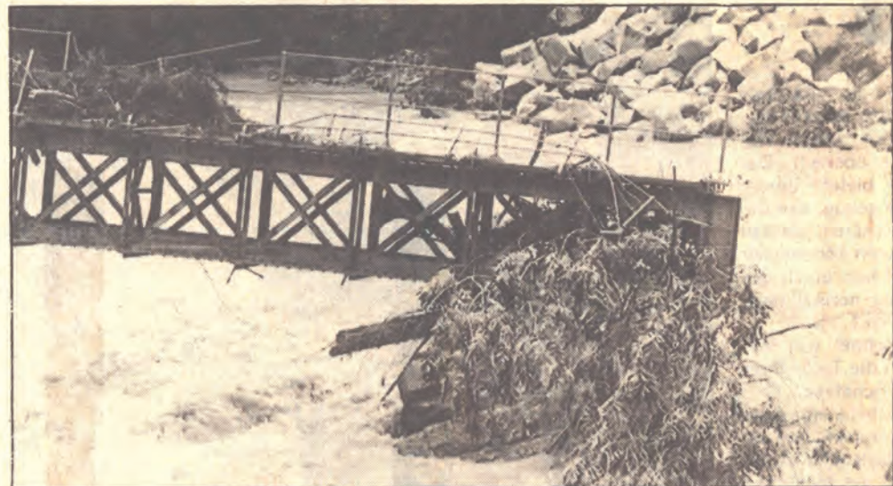
Mehr als hundert Brücken im ganzen Land beschädigt: im Bild Fußgängerbrücke über Sillschlucht
